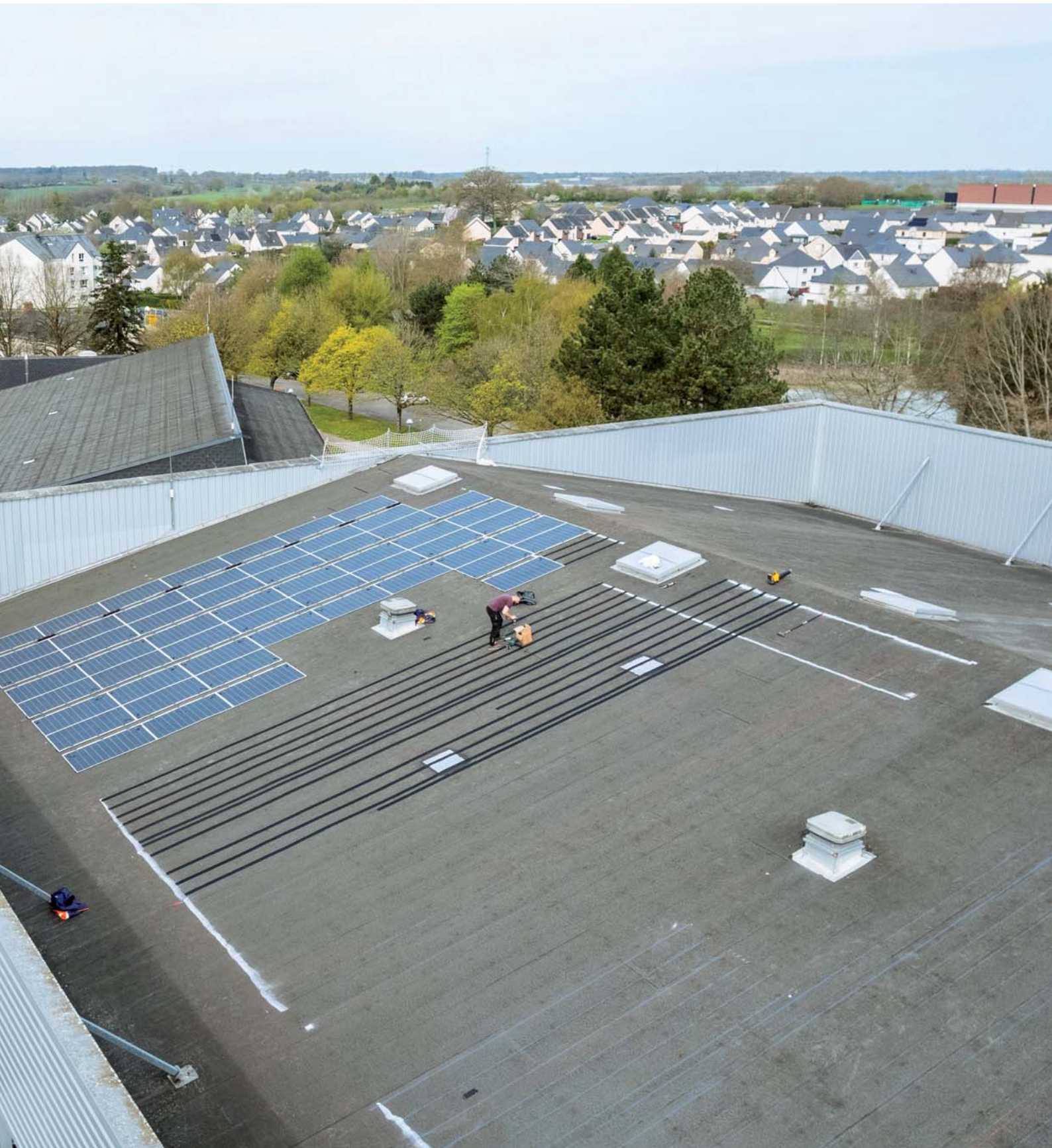
Pose de panneaux photovoltaïques souples sur le toit de la salle André Cosme à l'espace sportif B. Le Godais.
